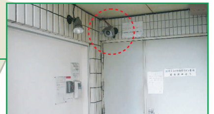
▼出入口の管理
